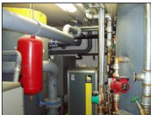
8. kép: Budapesti 88 lakásos társasház hőszivattyús hőközpontja
