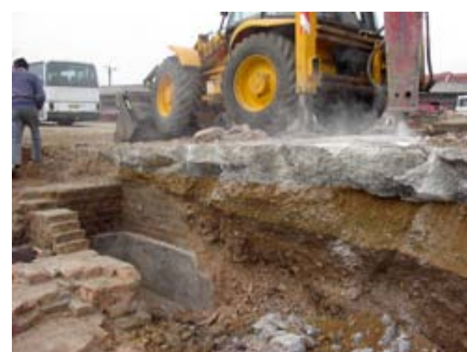
A 1980-as évek felvonulási telepének fél méter vastag betonlajza a feltárást megnehezítette.
