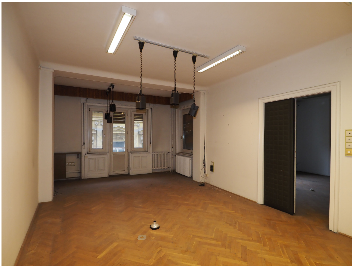
H10. Az erkélyre nyíló, II/17-es iroda az utcai traktusban. A tok-és parapetborítás eredeti, a nyílászárók újak
