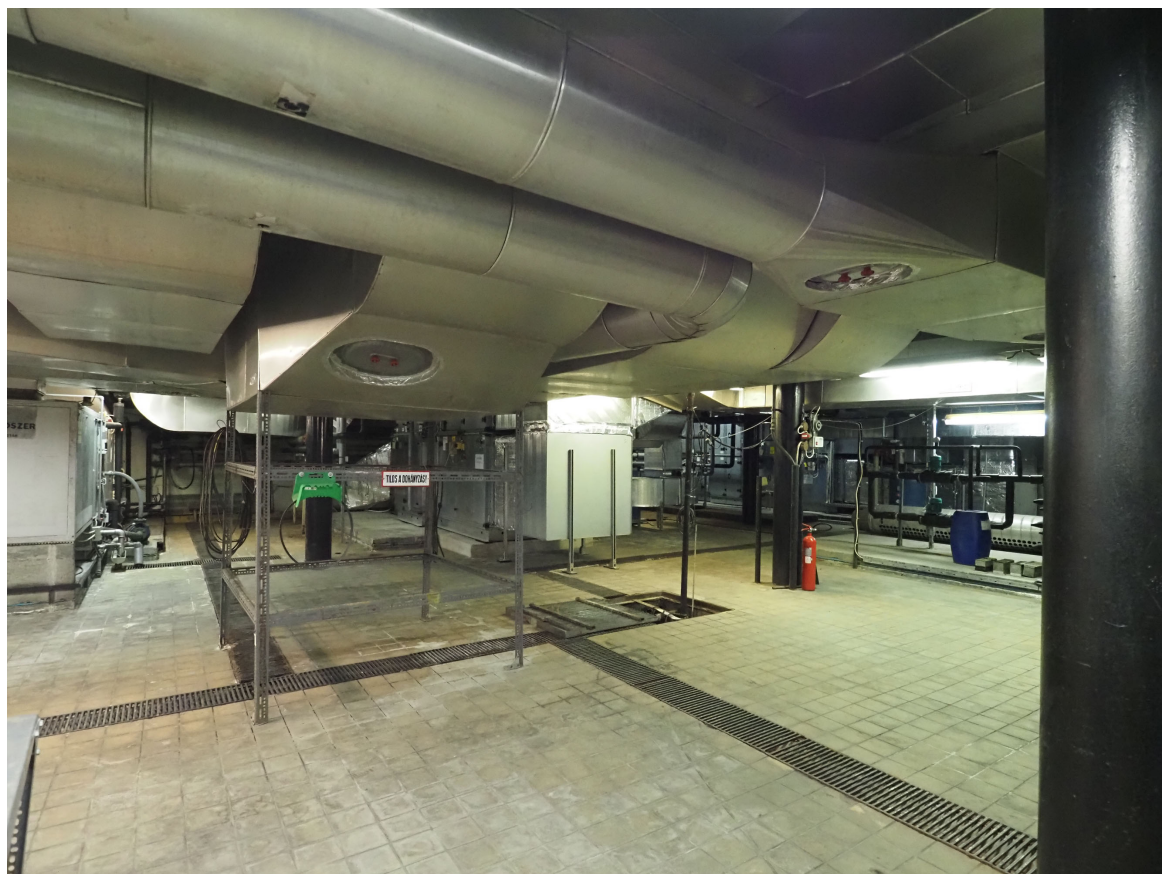
H8. Klímagépház a pincében
